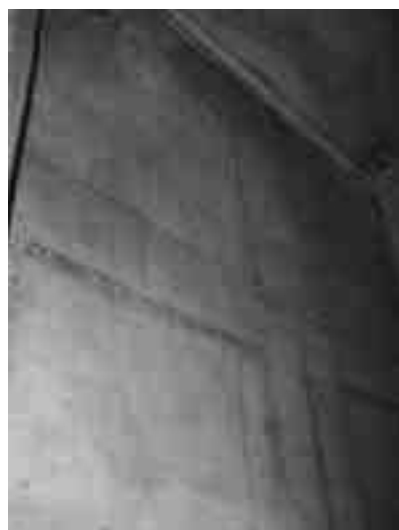
Stato fessurativo della parete P33c
