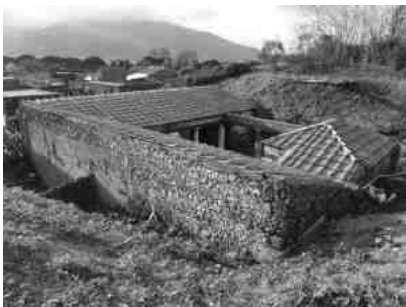
Livello del terreno a ridosso delle pareti P111, P112, P116
