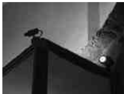
Figura 11. Sistema di illuminazione e di videosorveglianza collocati sopra la bussola di ingresso
