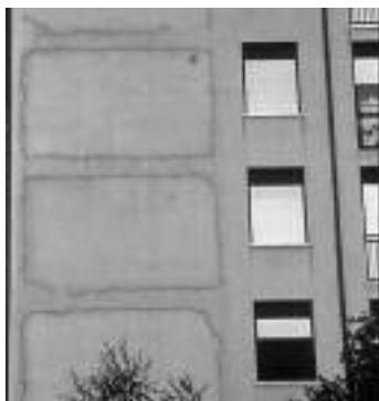
Fig. 3. Fessurazioni lineari corrispondenti alle pareti di tamponamento in un edificio con struttura a telaio. La fessurazione è dovuta all'accostamento di materiali a differente massa e differente coefficiente di dilatazione termica (strutture in cls armato e chiusure perimetrali leggere in laterizio). I fenomeni di dilatazione termica differenziata producono un quadro fessurativo che si evidenzia sull'intonaco.
