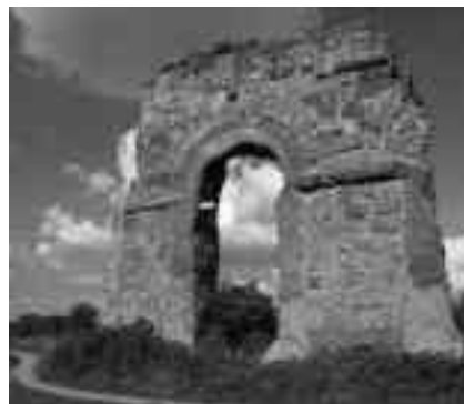
Fig. 3. Un tratto isolato dell'acquedotto Claudio in cui sono evidenti gli interventi di consolidamento operati nei sottarchi
