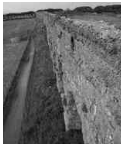
Foto 4. Il dislivello tra l'acquedotto ed il percorso pedonale
