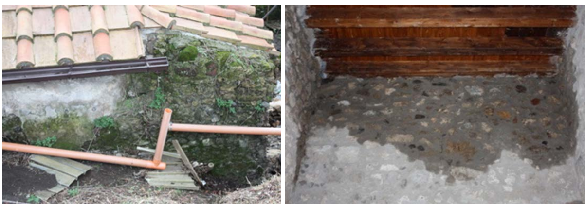
Pompei, Casa di Trebio Valente, Infiltrazioni di acqua da coperture recenti con carenti impermeabilizzazioni e inefficienze nei sistemi di allontanamento delle acque piovane.
