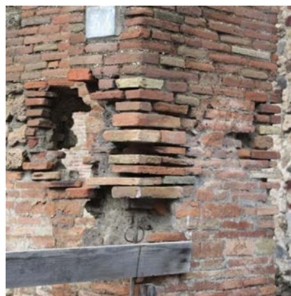
Pompei, carenti manutenzioni mettono in pericolo la stabilità delle murature
