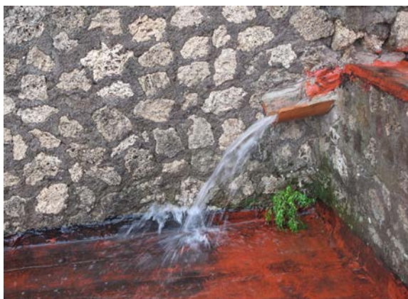
Pompei, Casa della Fontana Piccola, inefficienze nei sistemi di allontanamento delle acque piovane.
