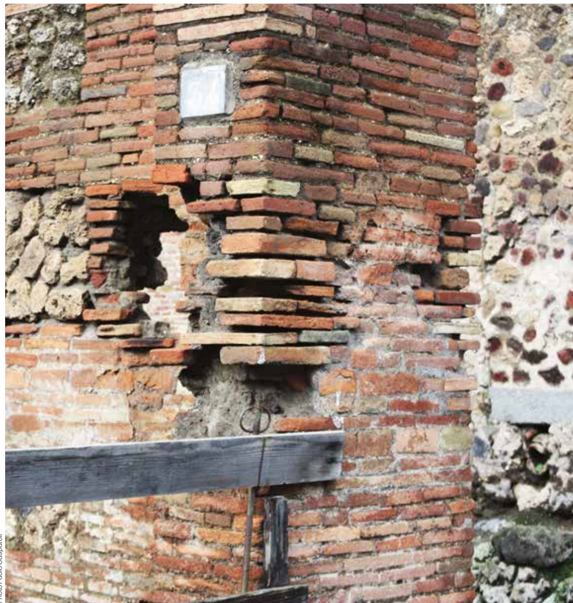
In questa pagina a sinistra e pagina a fronte: nell'area archeologica di Pompei, i prolungati fenomeni di ruscellamento delle acque meteoriche provocano consistenti erosioni delle malte di allettamento. Semplici interventi di stilatura delle fughe eviterebbero situazioni di instabilità, come il crollo della Schola Armaturarum (2010) This page at left and opposite page: in the archaeological area of Pompeii, the prolonged phenomena of runoff of meteoric waters causes considerable erosion of the mortar bedding. Simple pointing of the grouting would prevent instability, like the collapse of the Schola Armaturarum (2010)
